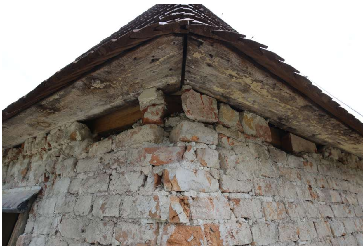
012 detail rozrušenej koruny muriva laterny po odstránení cementových omietok
