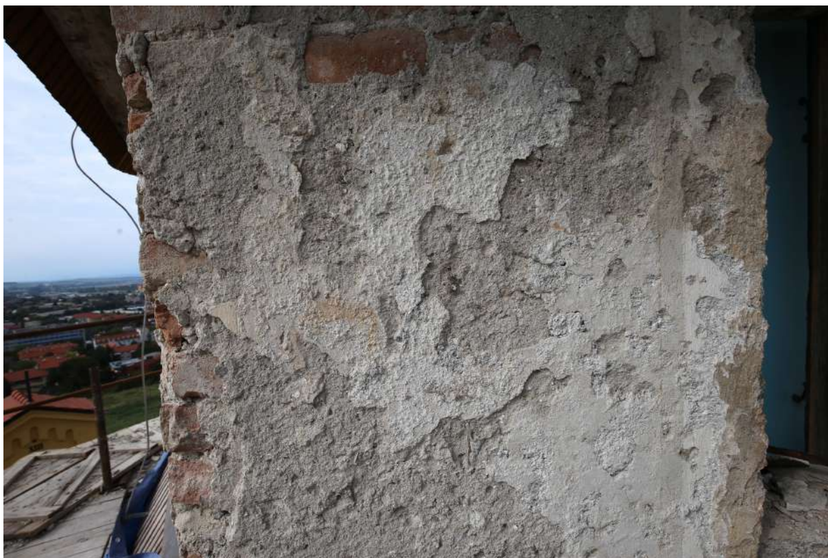
024 bývalá plastická páska lemujúcu okenný otvor zachovaná v odtlačku, tento nález staršej omietkovej úpravy bol zakonzervovaný a prekrytý novou vrstvou omietky
