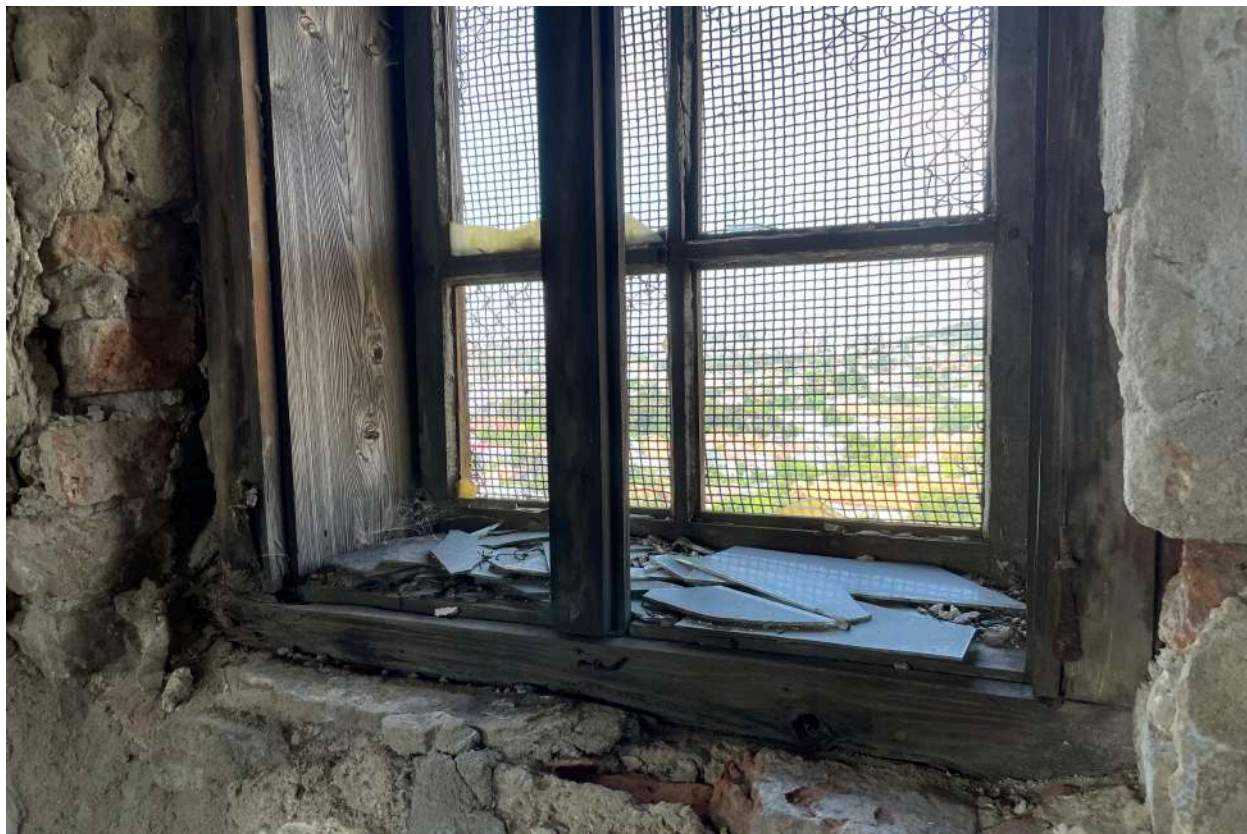
025 nálezový stav okna v laterne
