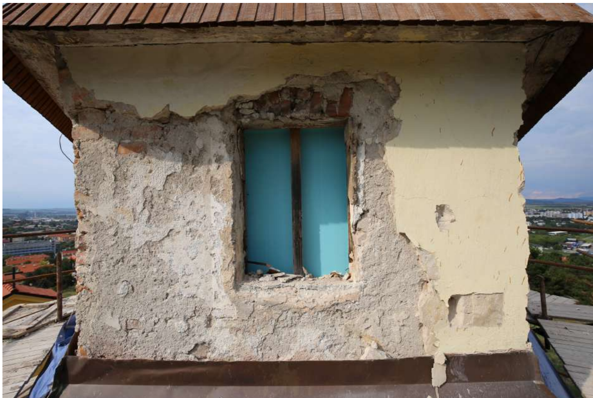
023 stav staršej odkrytej omietky, na fotografii vidno bývalú plastickú pásku lemujúcu okenný otvor
