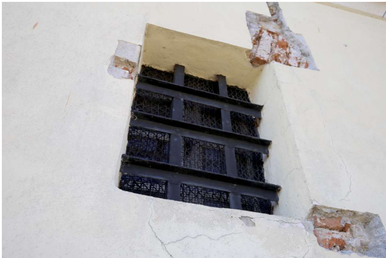
039 staršia nevhodná mreža situovaná v okne vyhotovená s nevhodných oceľových profilov v tvare L
